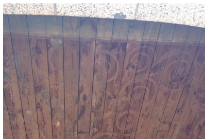
Före åtgärder. Utfällningar och missfärgningar av träet. Pigmenten är i stort sett borta. Syns vagt under ytsmutsen.
